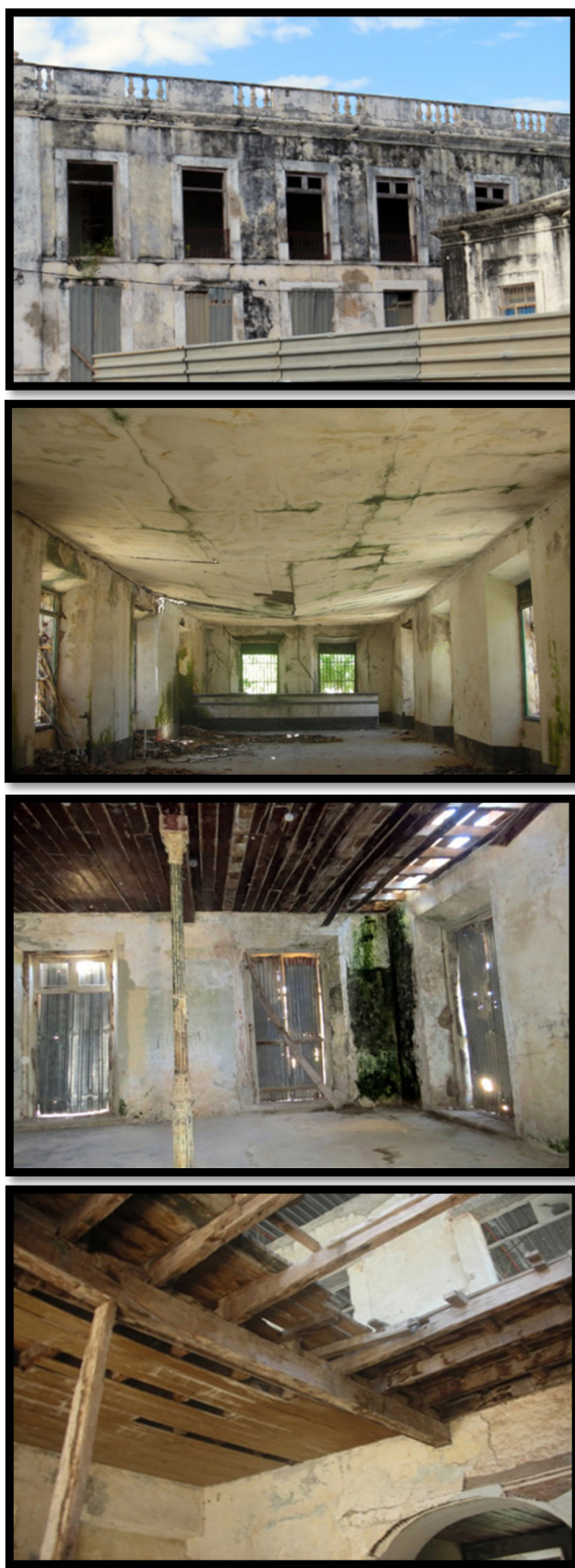
Figura 11: A degradação do edifício do Hospital de Moçambique (a funcionar actualmente como Centro de Saúde com internamento)
